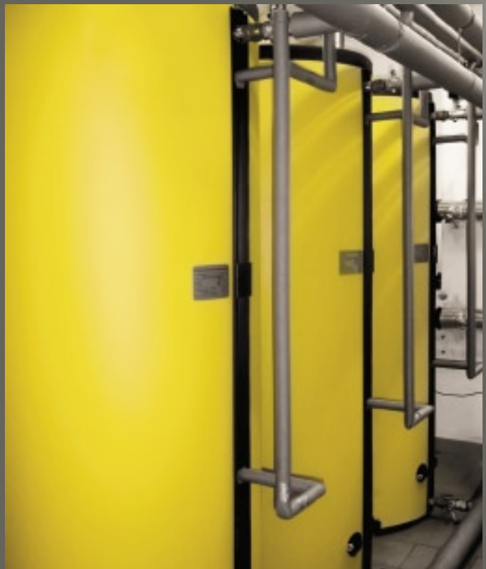
Ein Beispiel der Anlage PAST® in einem Hotel.
